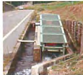
らせん型小水力発電設備
